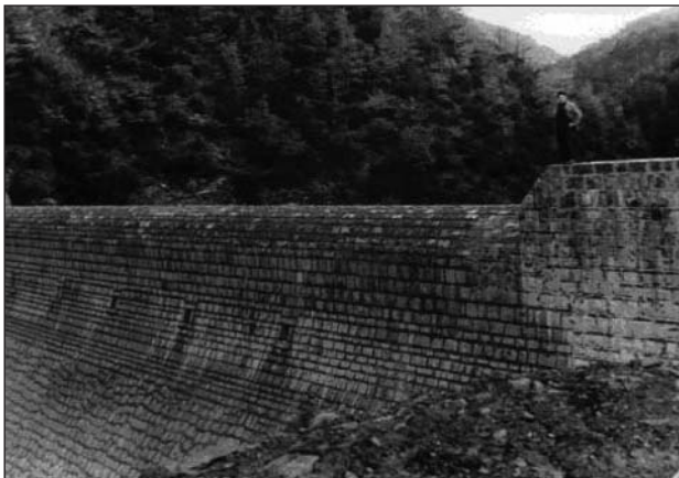
Fig. 16. Gran dique de mampostería hidráulica construido en el torrente de Sía en 1962, según la memoria de los trabajos realizados en ese año por la Dirección General de Montes, Caza y Pesca Fluvial. (Foto: José María Ayerbe)
