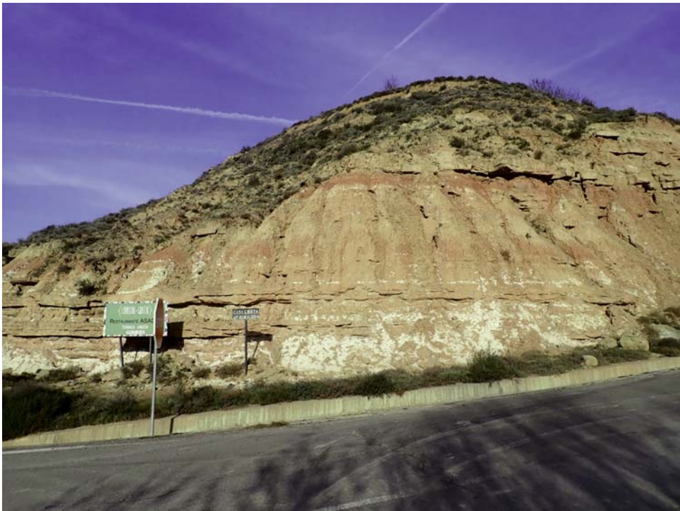
Fig. 6. Terrero a la entrada de la localidad de Lierta, donde se observa la diferente presencia de eflorescencias entre estratos. (Fotografía del 29 de enero de 2024)
