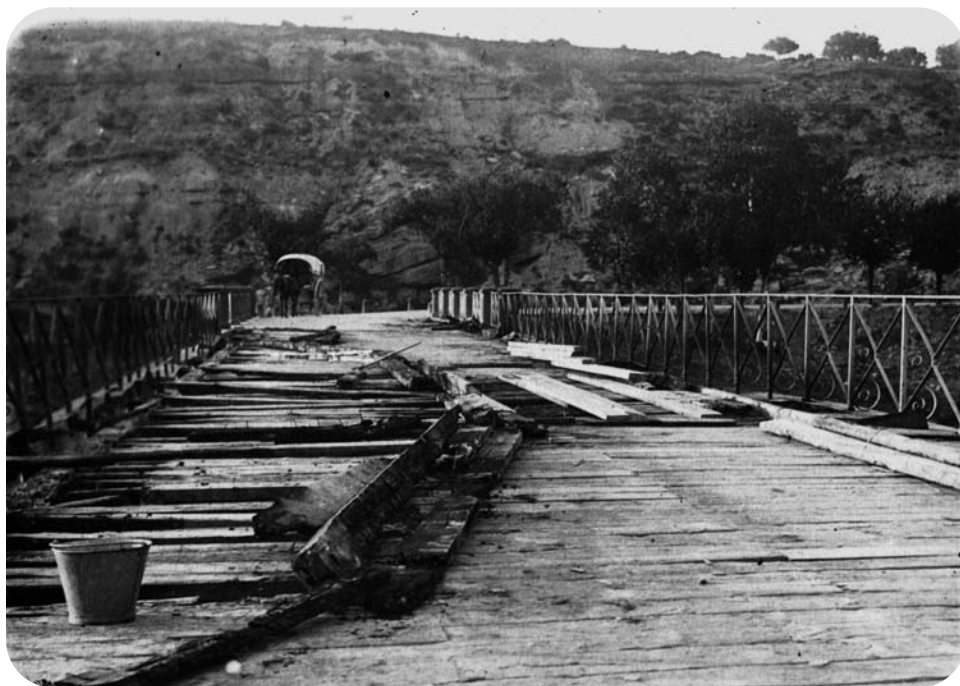
Fig. 7. Tablero incendiado del puente de Murillo de Gállego en 1916. (Archivo Histórico Provincial de Huesca)
