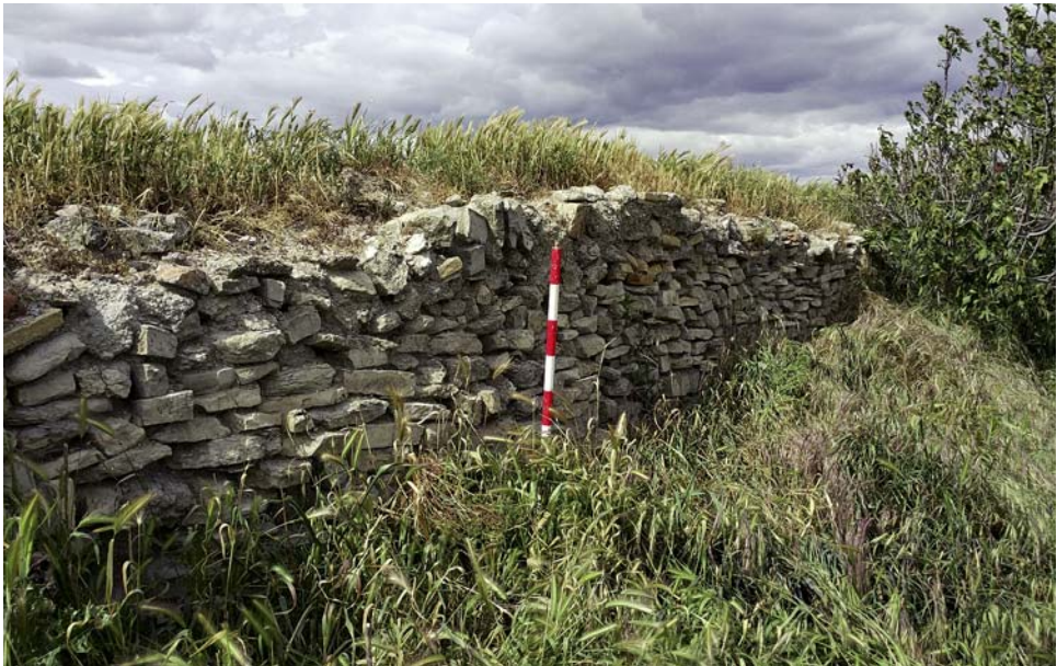
Fig. 1. Muro del terraplén junto al cementerio de Almudévar (ETRS89 30T. X: 700510; Y: 4657982).
