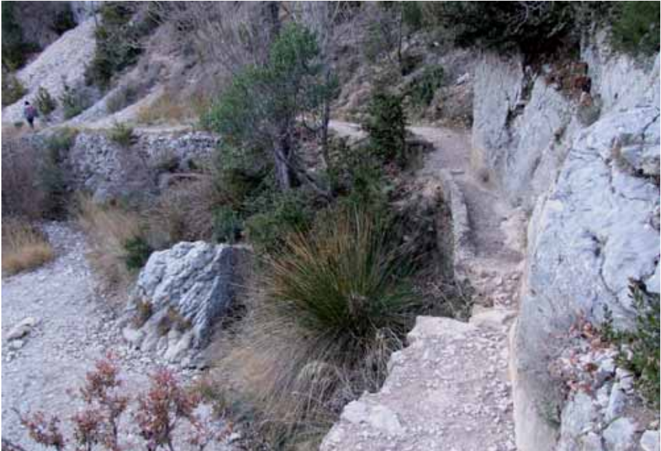
Fig. 21. La acequia entre los huertos de Lafarga y Manuel. Se aprecia el estado de la canaleta de obra y lo colmatado de todo el trayecto, hoy convertido en camino. (Fecha: 16/12/2007)
