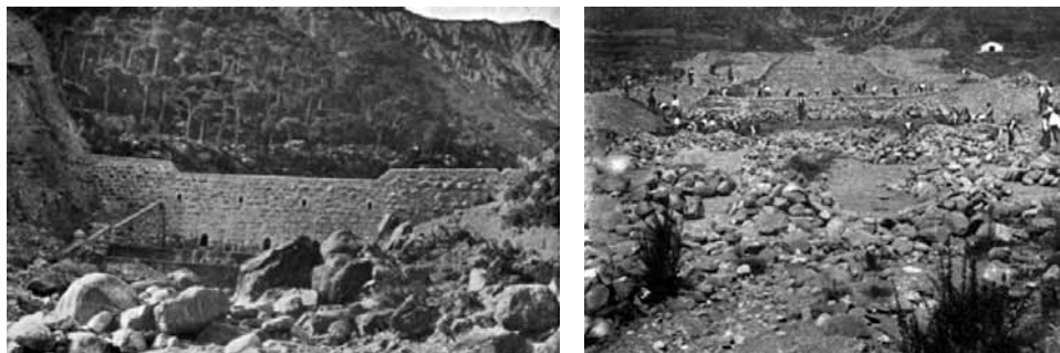
Fig. 10. Dos vistas del torrente de Arás hacia 1910. Izquierda: dique de cierre al final de la garganta del torrente. (Fototeca Forestal Española, DGB-INIA, 2004) Derecha: obras en el canal escalonado que atraviesa el cono de sedimentación del torrente. (Fotografía de la familia Ayerbe)
