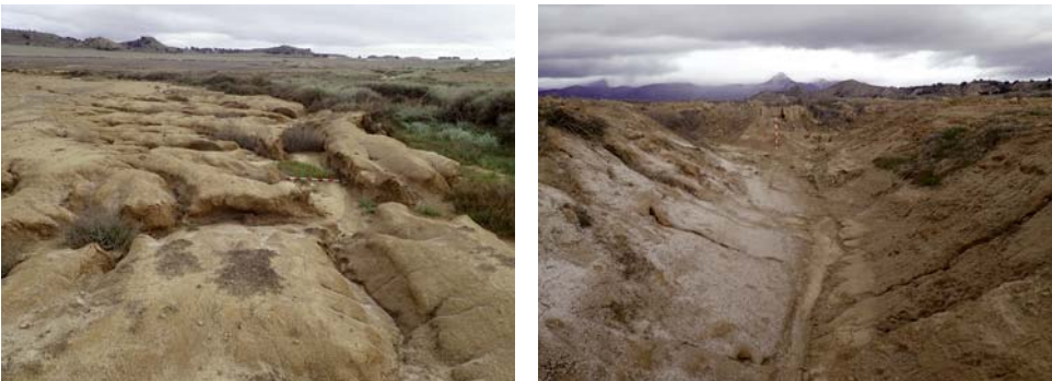
Figs. 2a y 2b. Erosión reciente en la Paúl de Anzano. (Fotografías del 3 de enero de 2025)
