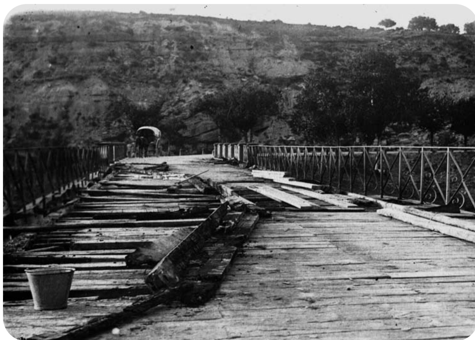
Fig. 7. Tablero incendiado del puente de Murillo de Gállego en 1916. (Archivo Histórico Provincial de Huesca)
