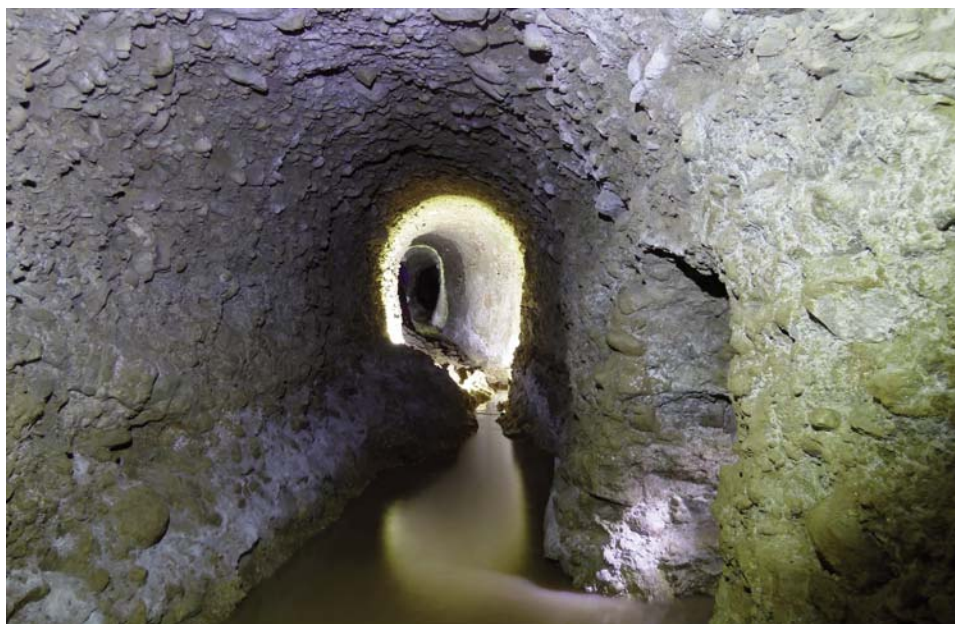
Fig. 7. Galería principal tras el dintel y salida del ramal oeste, a la derecha.
