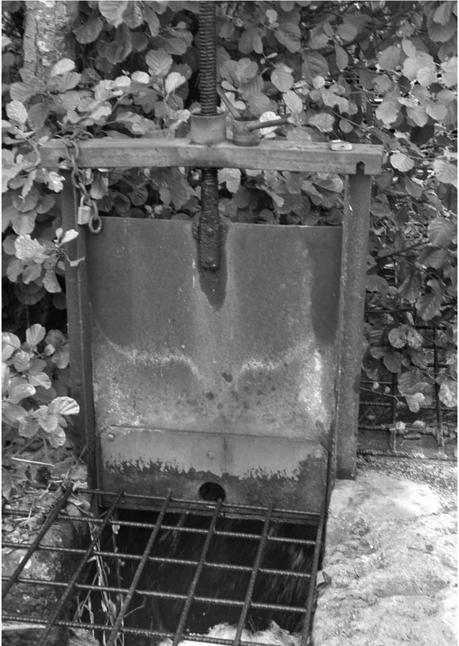
Figura 3. Compuerta en el partidor de Abrisén, con paso para agua de servicios.
