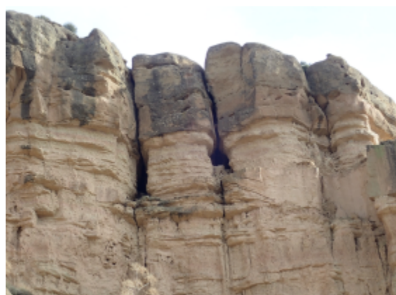
Fig. 18. Grietas en un lateral de la Peña Miramiel.
