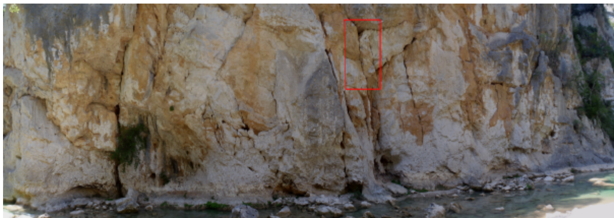
Fig. 2. Ubicación de la fisura con estacas en el río Alcanadre.
