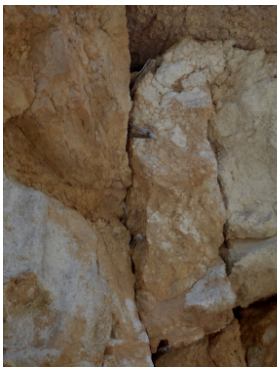
Fig. 3. Fisura con estacas en el río Alcanadre.
