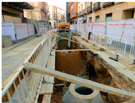
Fig. 2. Zanjas de grandes dimensiones abiertas en el Coso Bajo de Huesca para la sustitución de la red de saneamiento.
