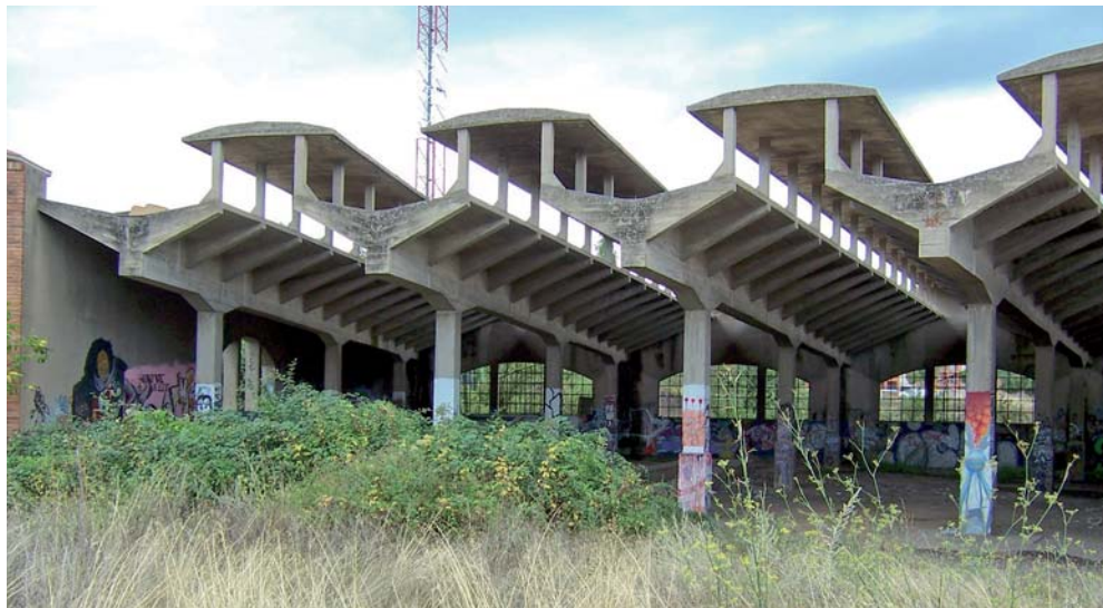
Nave de máquinas de la antigua estación de ferrocarril de Tarazona. (Foto: Carlos Colás)
