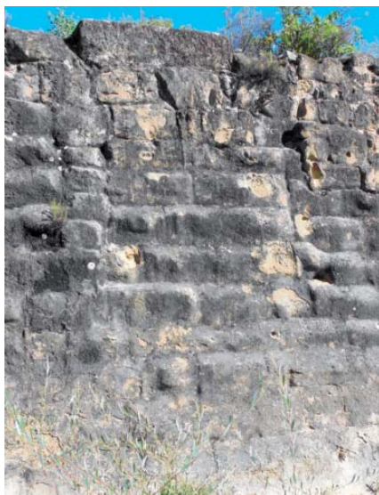
Figura 3. Pantalla de la presa. Sillares almohadillados a soga y tizón en la cara exterior.
