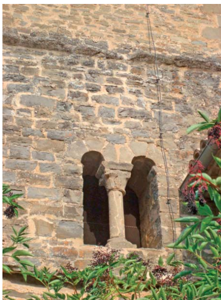
Figura 6. Vanos del lado oeste de la torre de la iglesia de San Juan de Rodellar.
