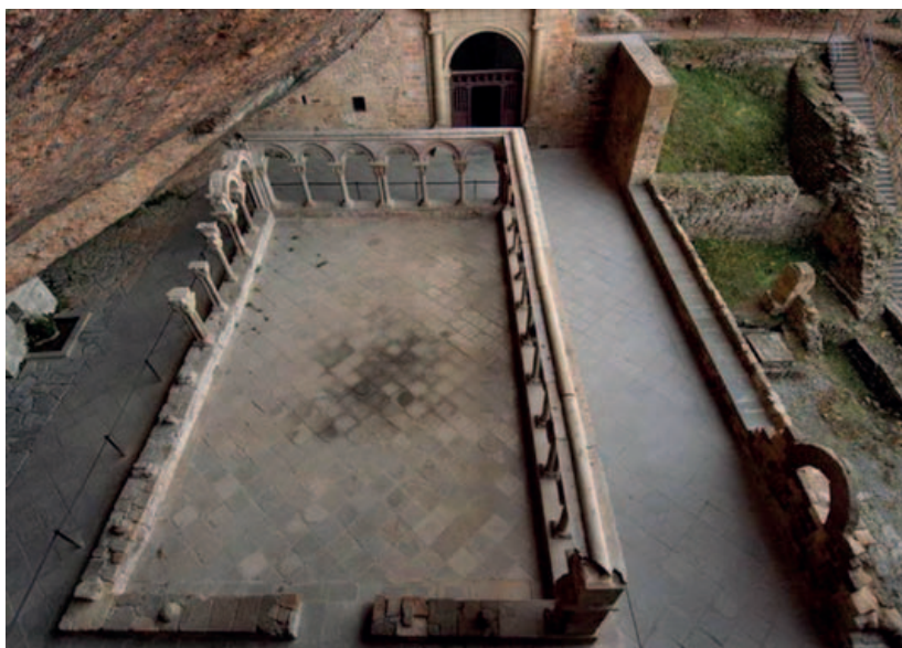
En el centro del claustro puede observarse la permanente mancha de humedad. (Foto: Antonio García Omedes)
