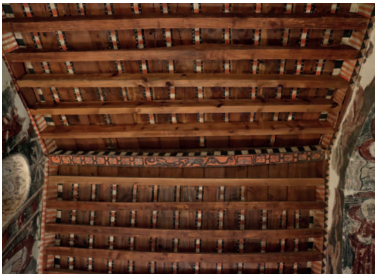
Techumbre de la iglesia de San Miguel de Barluenga. Sección de la capilla mayor. Finales del siglo XIII. (Foto: M.ª Celia Fontana Calvo)
