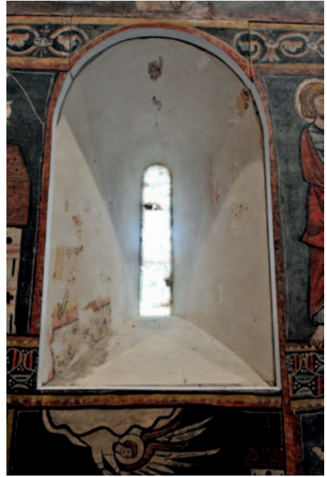
Vista actual de la ventana abocinada del testero desde el interior. (Foto: Pablo Otín, octubre de 2023)
