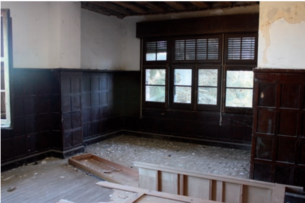
Interior del salón comedor de la vivienda del ingeniero. (Foto: Javier de la Fuente Cobos)
