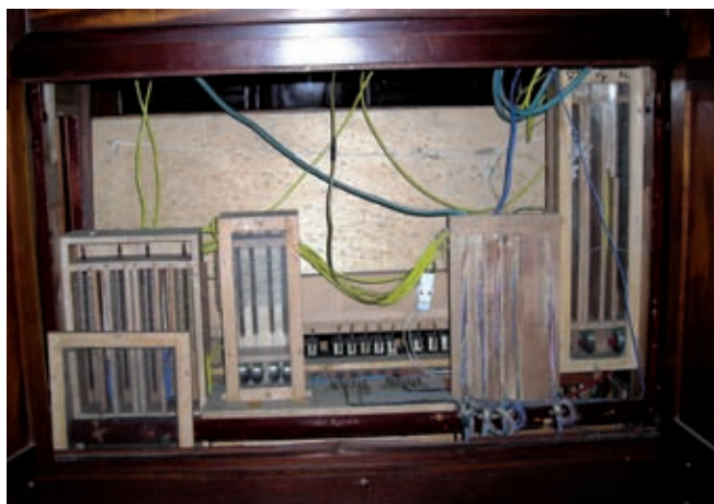
Vista interior del armario de la consola, donde se aprecian las transmisiones eléctricas.
