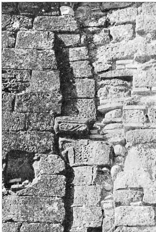
Actual muro E, cerrado al eliminarse el antiguo ábside. Obsérvese el arranque del arco triunfal
