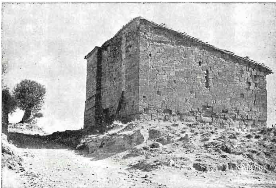
Vista general Virgen de Mueras. Obsérvese el ligero apuntamiento del vano—muro W—.
