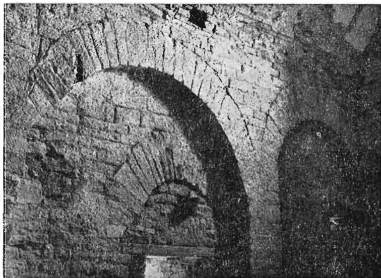
Detalle de la articulación del muro sur y de la puerta tabicada
