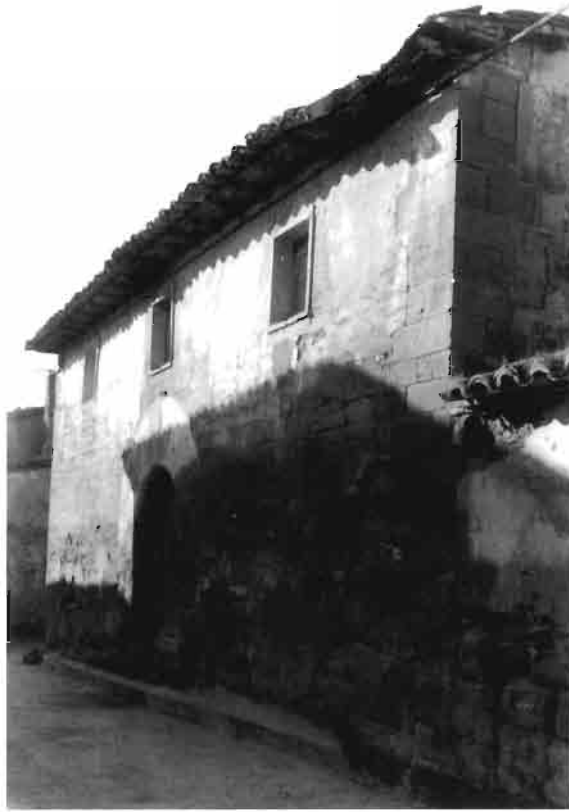
Fot. 1. Fachada principal del edificio del hospital de pobres de Ayerbe a finales de la década de los 80. Todavía puede apreciarse la existencia del alero original, que ya comenzaba a degradarse. (Foto: C. JALLE).
