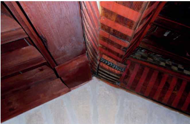
Detalle del techo mudéjar: piezas originales y elementos sustituidos. (Foto: M.ª Blanca de la Eucaristía Barril)
