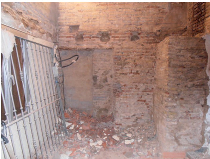
El locutorio de la Sagrada Familia en obras. Al fondo, una puerta tapiada enfrente de la puerta regular. A la derecha se aprecia parte de la chimenea del antiguo horno crematorio. 2015. (Archivo del convento de la Encarnación de Huesca)
