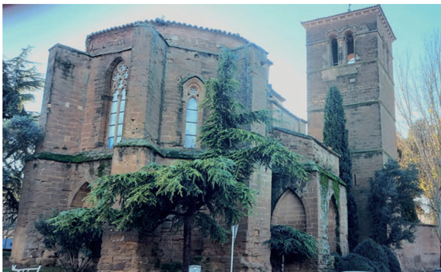
El ábside y la torre en la actualidad. Se observan humedades en la base, síntomas de deterioro de la fábrica de sillería y un crecimiento descontrolado del arbolado. (Foto: Jesús Ramón Tejada Villaverde)
