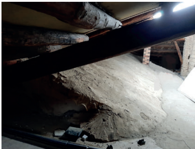
Trasdós de la vertiente sur de la techumbre en la zona de los pies de la iglesia, alojado en las falsas del convento. (Foto: M.ª Blanca de la Eucaristía Barril)
