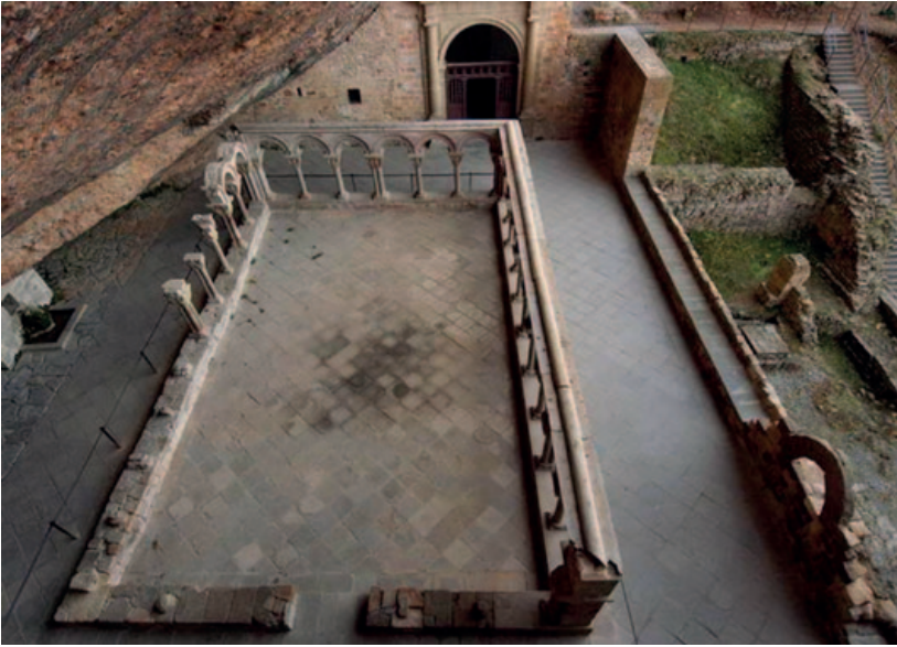
En el centro del claustro puede observarse la permanente mancha de humedad. (Foto: Antonio García Omedes)
